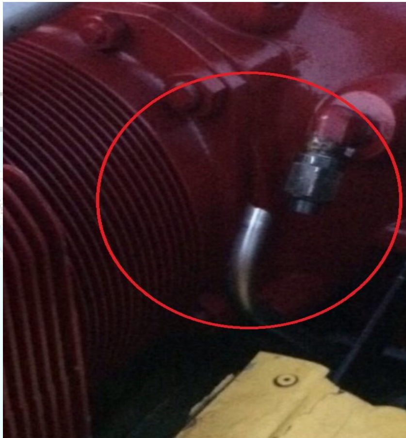
Figura 4 – Vista da mangueira do sistema de lubrificação do motor rompida. |
