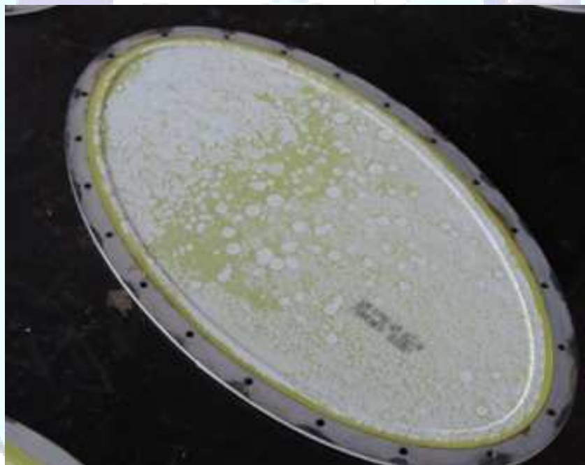
Figura 1 – Material esbranquiçado nas janelas de inspeção de combustível do PP-EMO.
