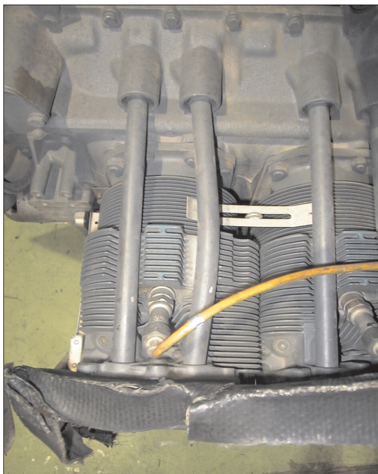
Figura 1. Varillas empujadoras del cilindro n.º 2
