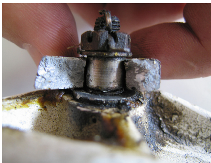
Figura 3. Rotura de la orejeta del herraje
