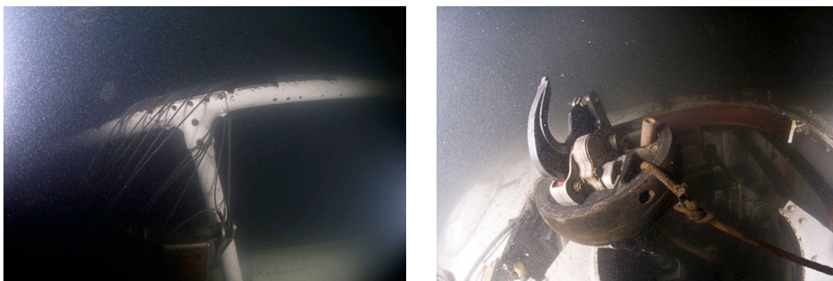
Figura 6. Estado de los cables y del gancho del depósito
