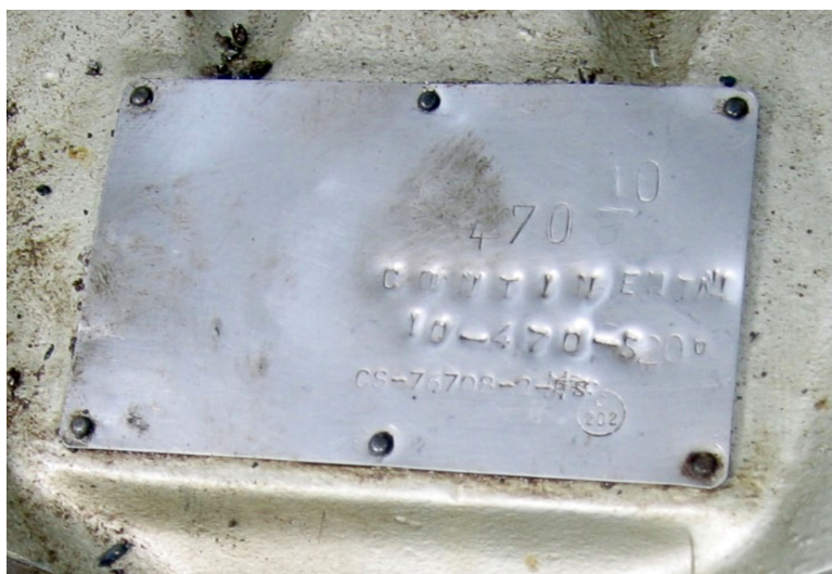
Figura 3. Placa de identificación instalada en el motor
