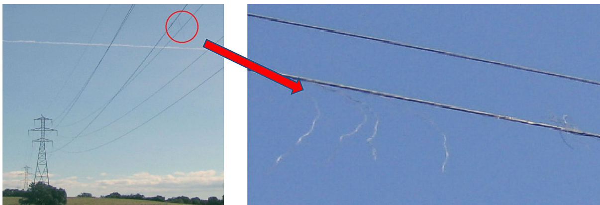
Figura 3. Daños ocasionados en una de las fases del tendido
