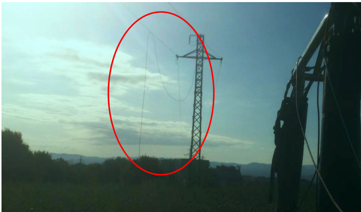
Figura 3. Cable del tendido eléctrico seccionado
