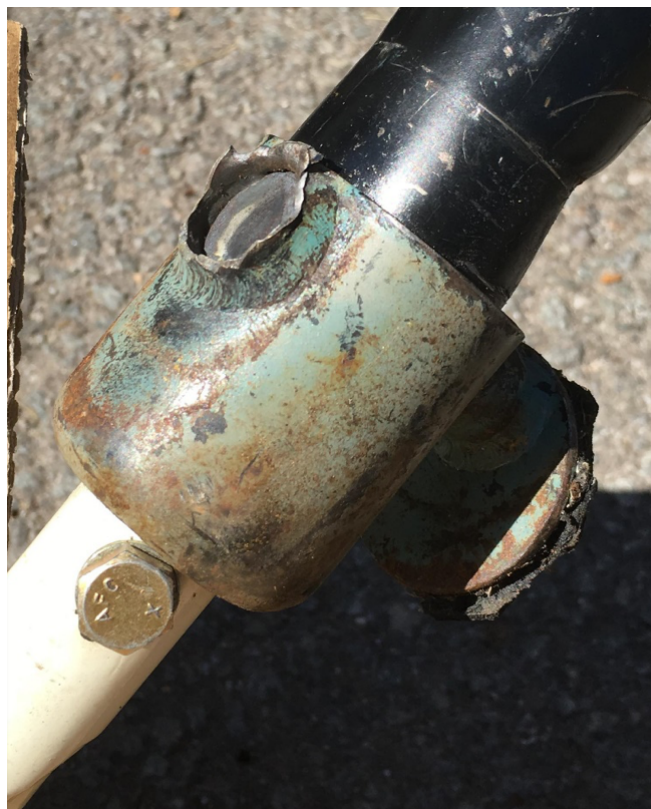
Figura 4. Detalle rotura de orejeta de riostra izquierda del tren principal
