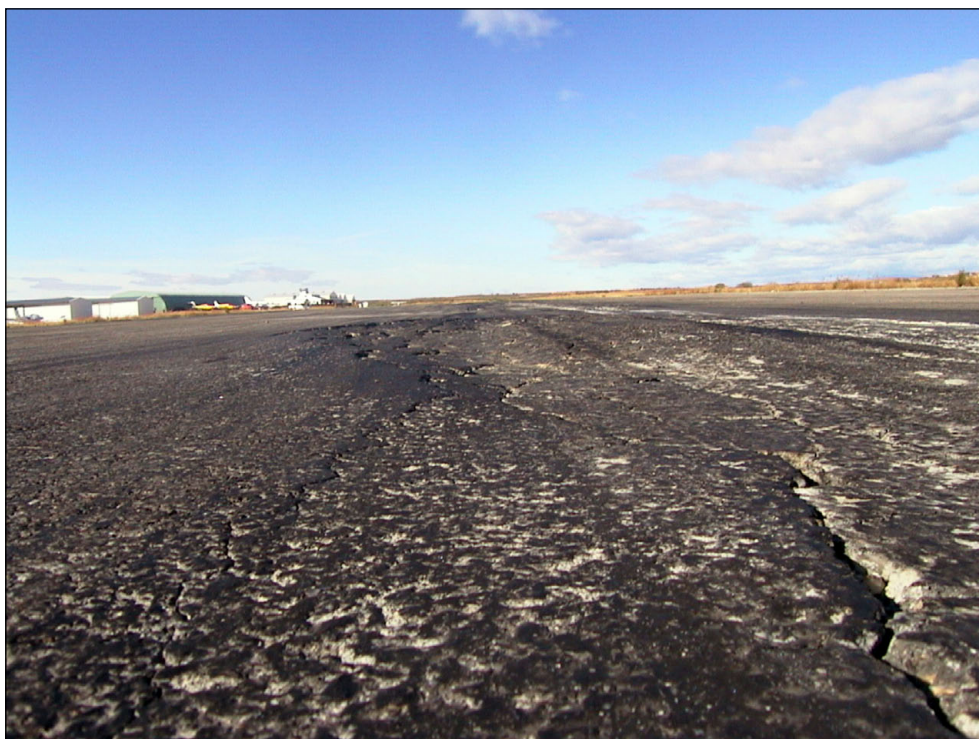
Foto 1. Estado del pavimento de la pista
