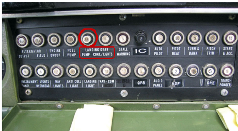
Figura 6. Detalle de la posición del disyuntor correspondiente a la bomba de tren
