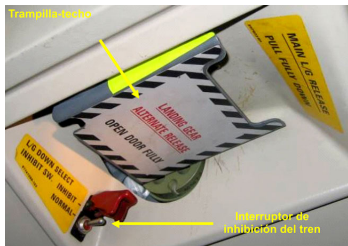
Figura 4. Interruptor de inhibición del tren
