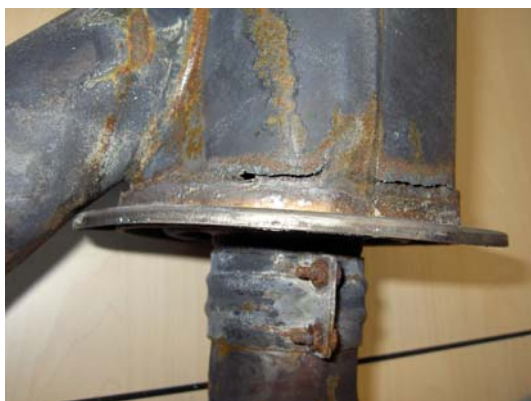
Enkele scheuren in de uitlaatdemper
