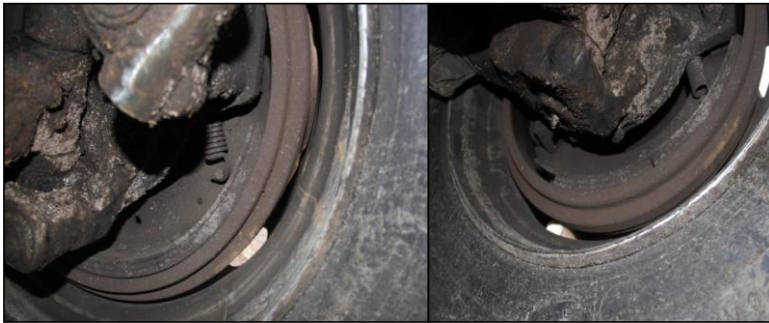
Tromol roda depan dan belakang tidak ada penutupnya
