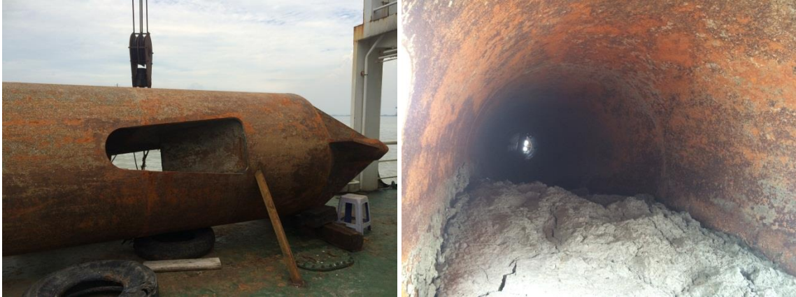
Gambar I-30: kiri: ujung spud pile, kanan: kondisi rongga dalam spud pile.
