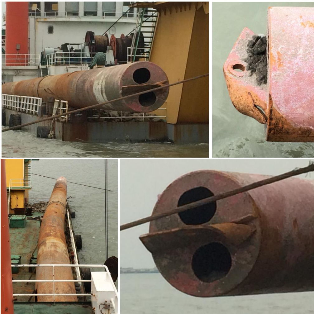
Gambar II-4: Profil kerusakan pada eyepatch dan bengkokan pada badan spud pile
