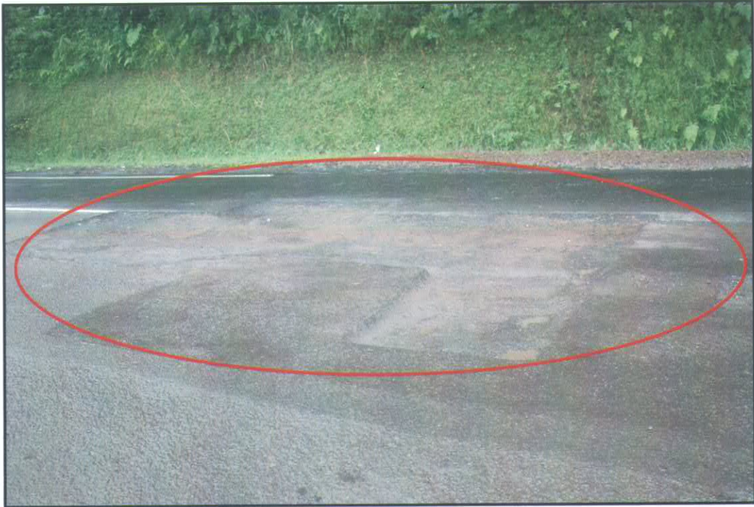
Gambar 2. Lubang yang dilintasi oleh mobil bus sebelum menabrak dinding tebing
