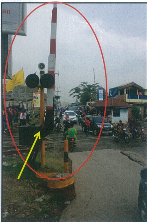
Gambar 8. Palang pintu perlintasan yang berada di sebelah kiri dari arah Tambelang menuju Cibitung dalam kondisi rusak / tidak berfungsi
