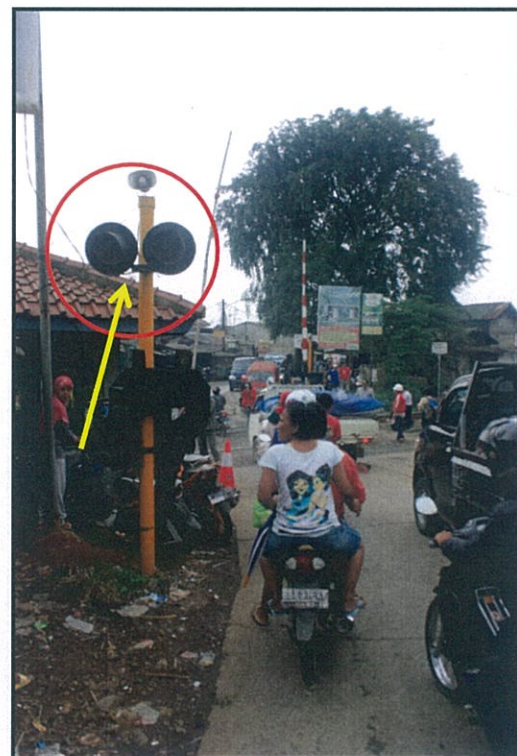
Gambar 6. Rambu perpotongan sebidang jalur ganda dilengkapi dengan sirine dan sepasang lampu merah yang berkedip bergantian dalam kondisi tidak berfungsi
