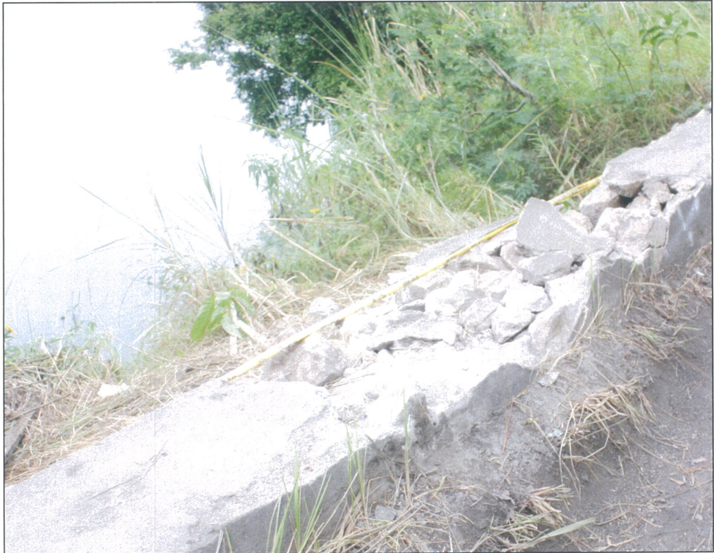
Gambar 3. Tembok pembatas jalan yang rusak akibat tertabrak
