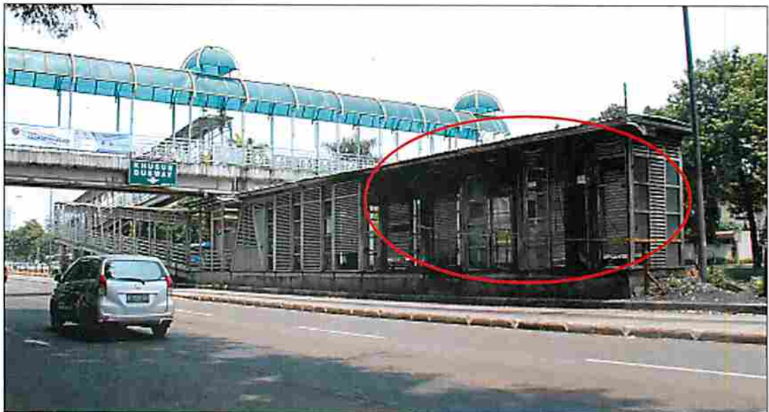
Gambar 1. Kondisi halte bus Al Azhar setelah terbakar
