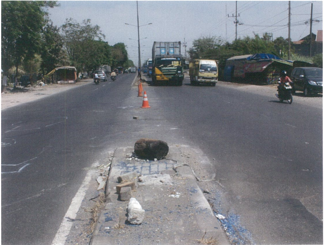
Gambar 1. Kondisi ruas jalan Trosobo tempat terjadinya kecelakaan
