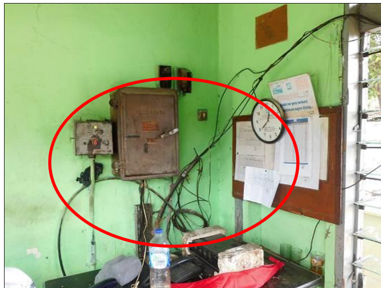
Gambar 8. Instalasi kabel listrik pada panel yang mengatur palang pintu di gardu JPL 57A yang tidak diinstal dengan rapi
