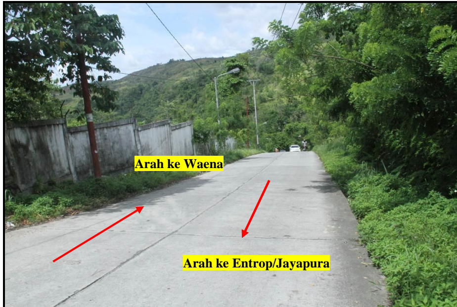
Gambar 25. Kondisi ruas jalan alternatif Perumnas III Waena – Entrop tanpa marka tengah dan batas tepi jalan.
