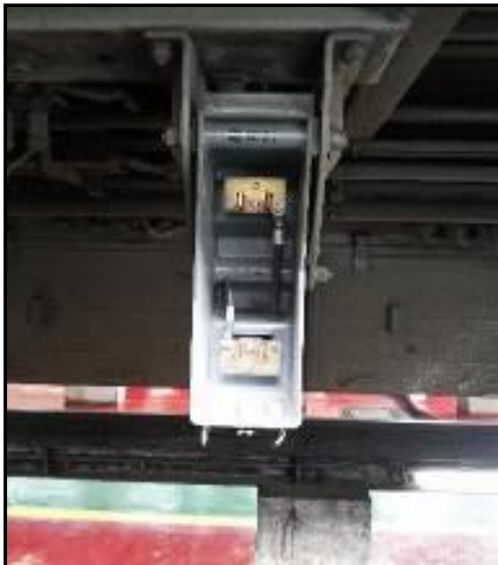
Gambar 11. Tutup fuse box (kotak sekring) dan fuse (sekring) hilang.
