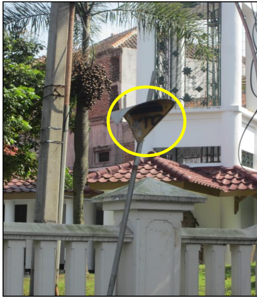
Gambar 17. Kondisi rambu peringatan tanjakan yang terlipat
