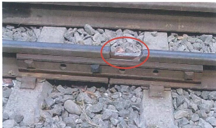
Gambar 5. Rel yang gompal di Km 47+650
