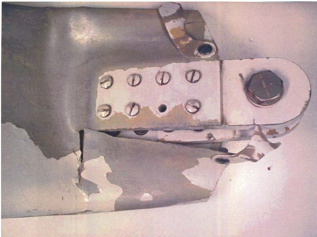
Foto n. 11: configurazione installativa del tronco di controventatura lato attacco sub-alare destro.
