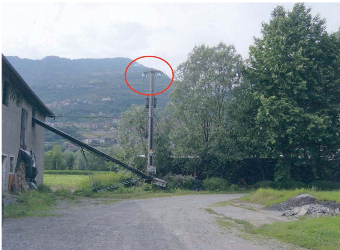
Installazioni elettriche facenti parte della linea impattata.
