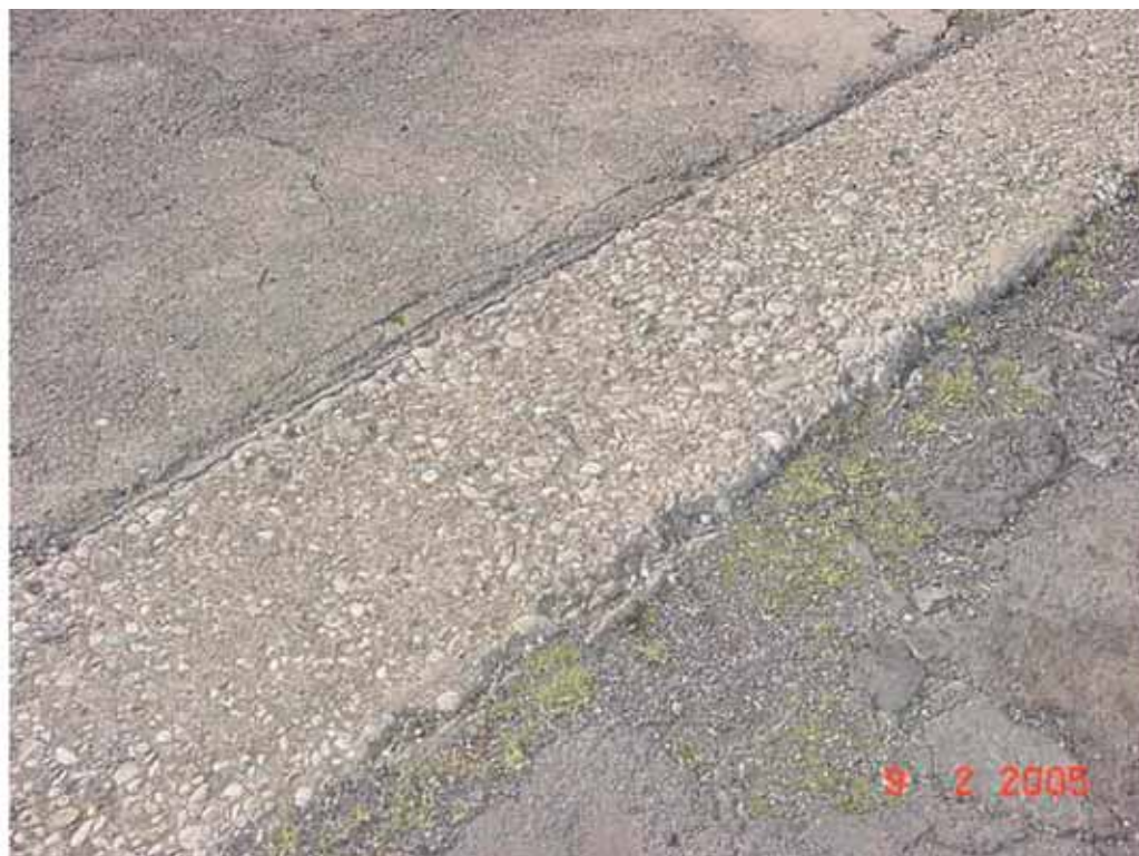
Protuberanza dell'asfalto, presente nell'area di parcheggio.
