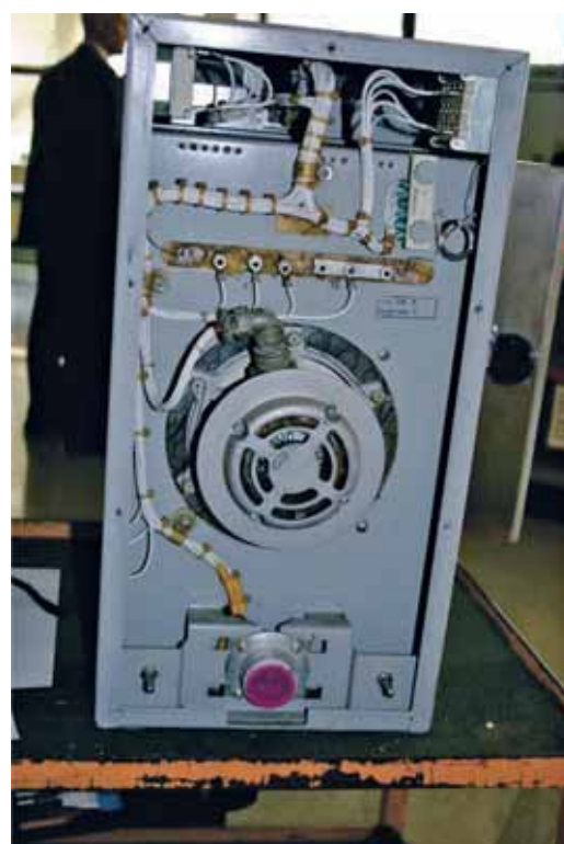
Vista posteriore del forno n. 1, con motorino e cablaggi elettrici.
