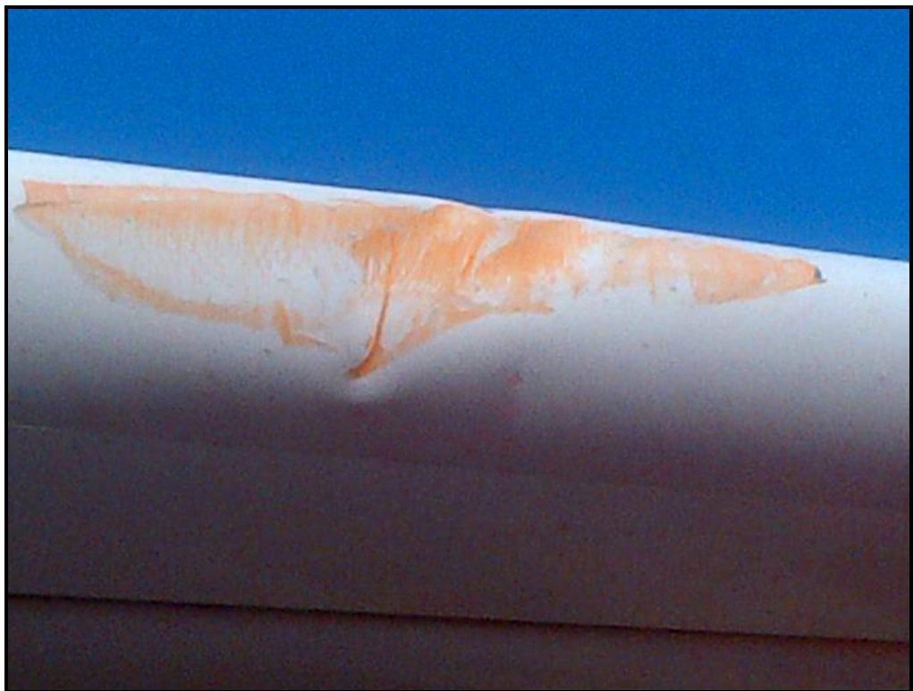
Foto 16: danneggiamenti sullo slat .
