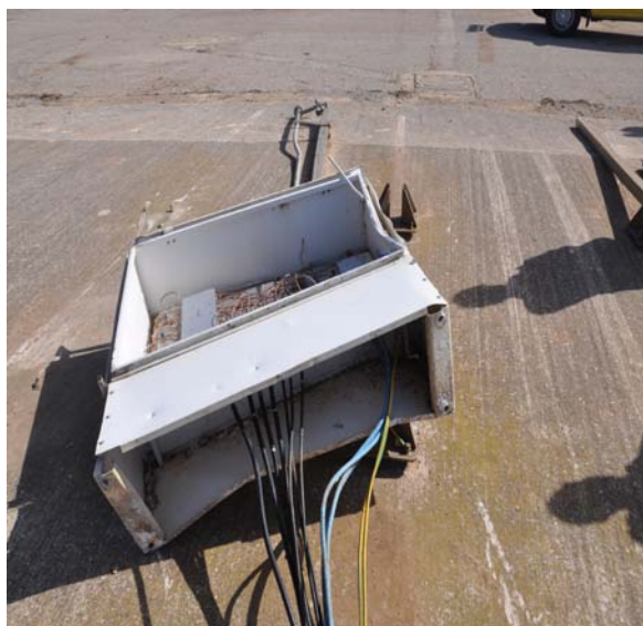
Foto 30: particolare della cabina elettrica.
