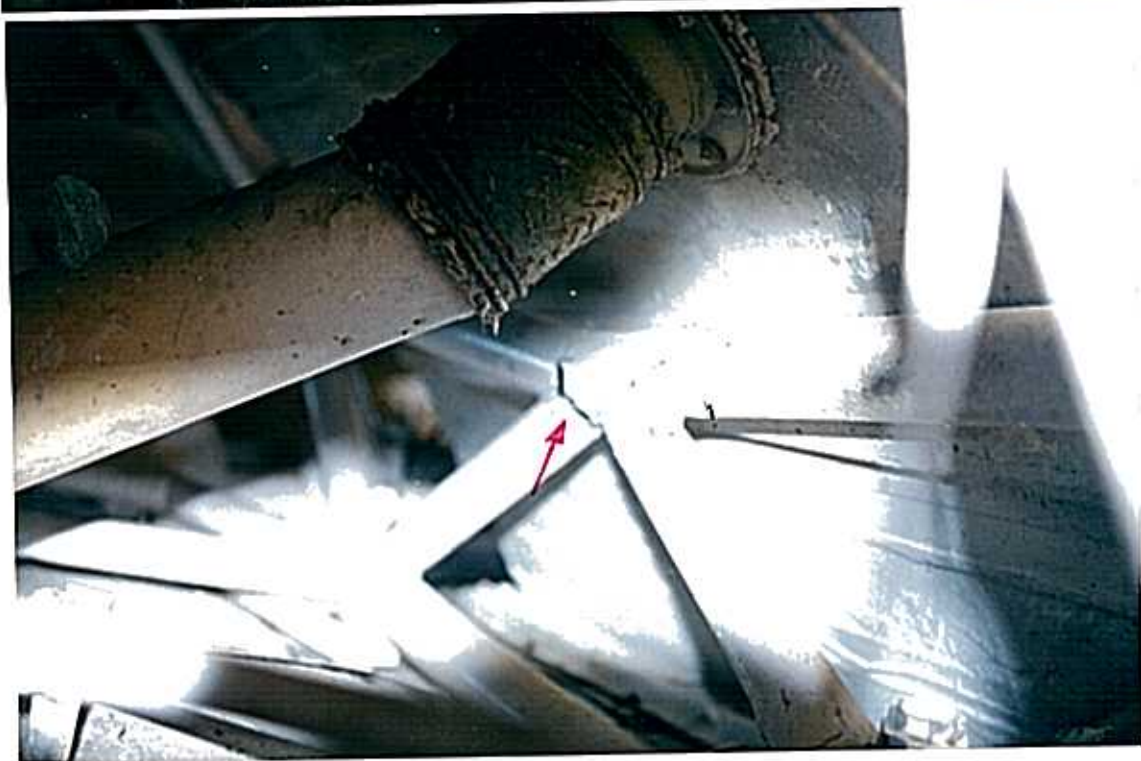
DANOS NA ESTRUTURA TUBULAR
