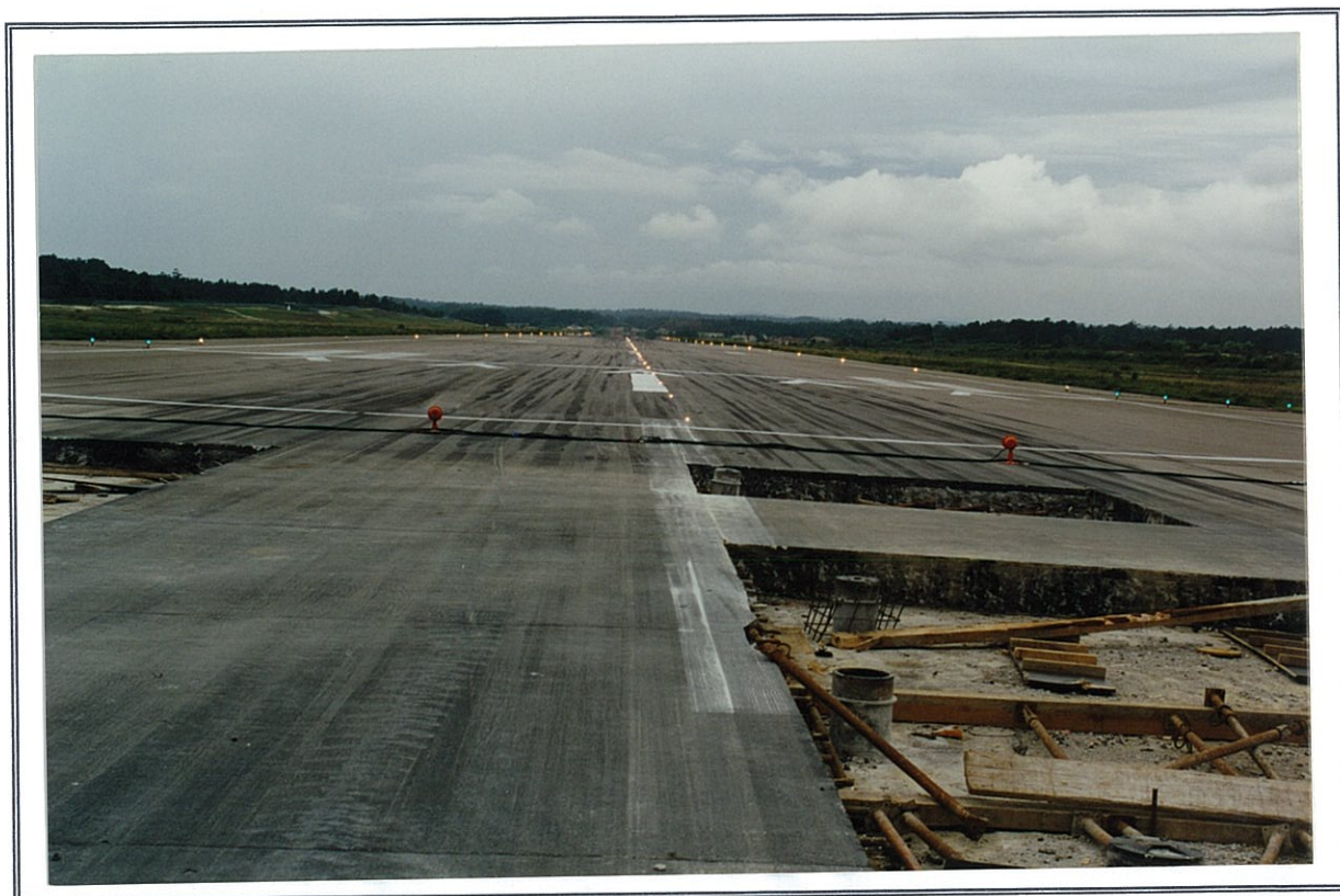
SOLEIRA DESLOCADA, MARCAS NA PISTA E CAIXAS DE OBRAS
