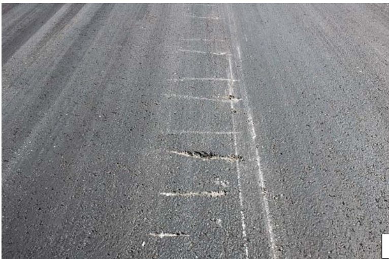
Fig. 6 – Marcas do hélice no asfalto.
