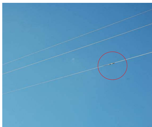
Fig. 6 – Disposição triangular dos cabos, notando-se uma das emendas feitas pela EDP.
