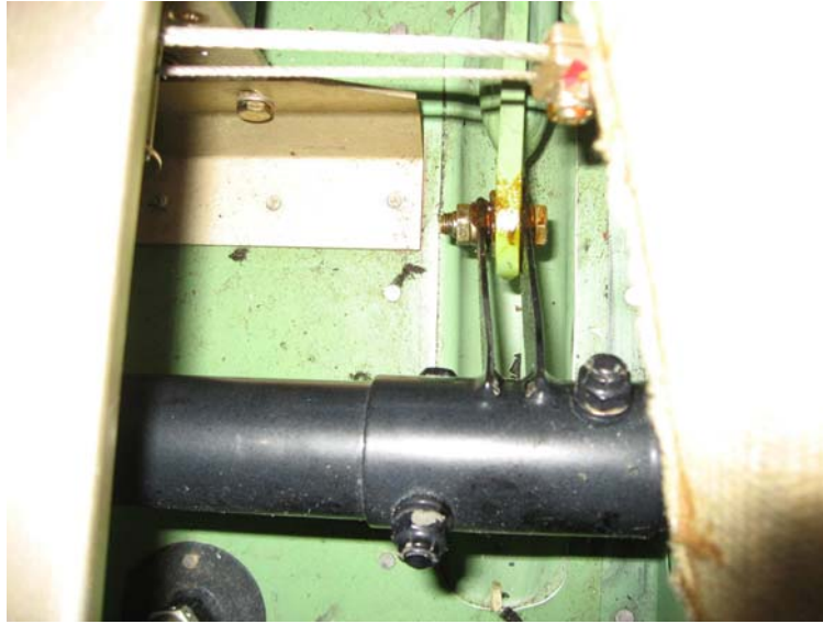
Fig. 14 – Pormenor do desalinhamento da ferragem de fixação da rótula do parafuso sem-fim ao tubo de torção de accionamento dos flaps num avião idêntico observado na Academia Aeronáutica de Évora.
