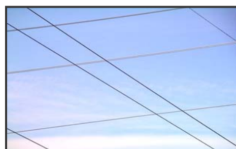
Figura nº 2. Linhas de alta tensão.
