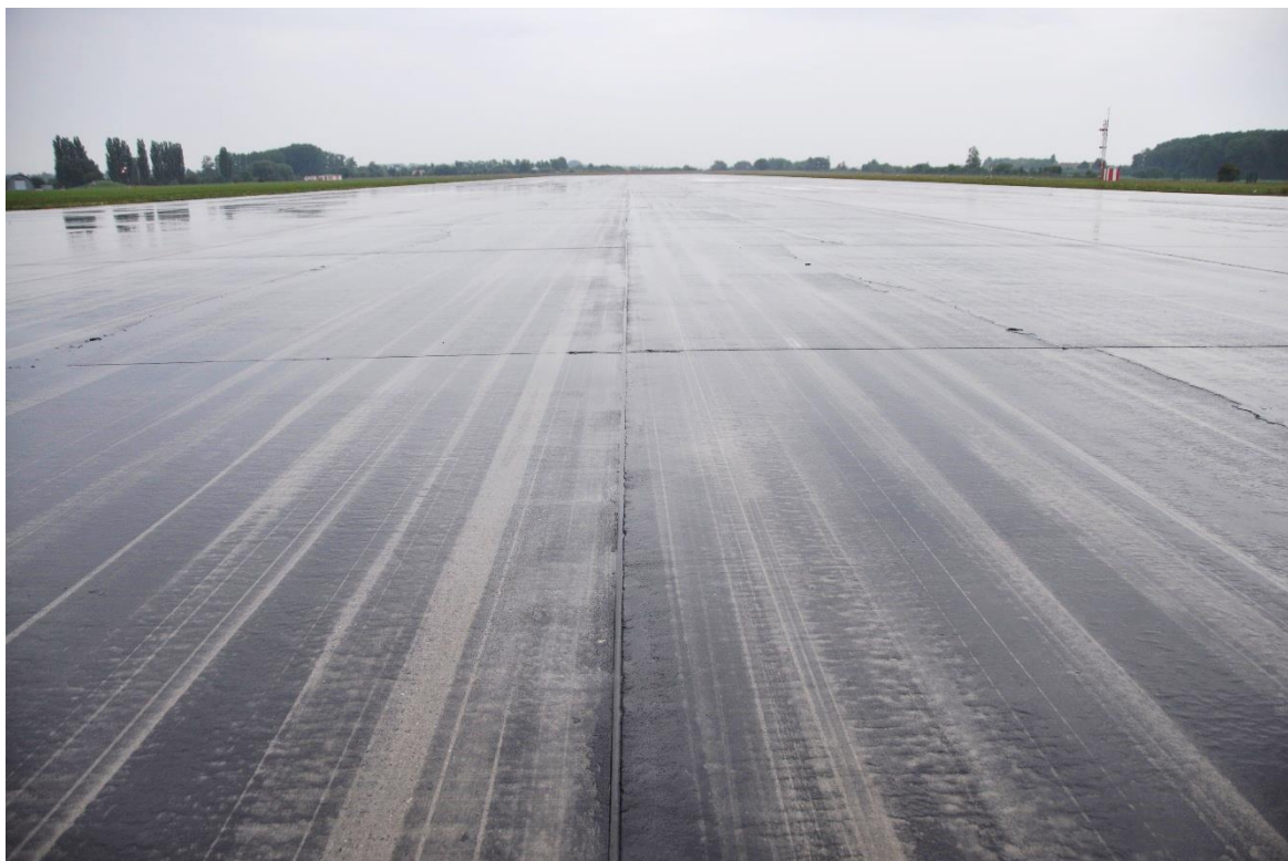
Zdokumentovaný stav povrchu dráhy na úrovni TWY B, směrem k THR 27
